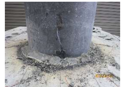
(b) 試験後の PHC 杭の状況
