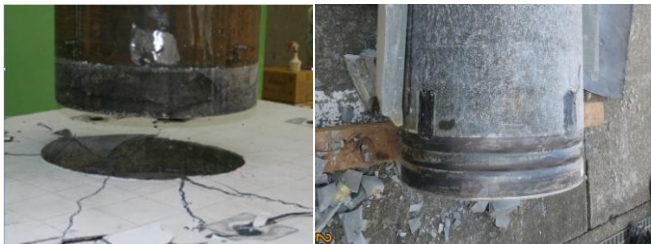
写真.1 試験後の基礎及び杭体の状況 (NO.1)
